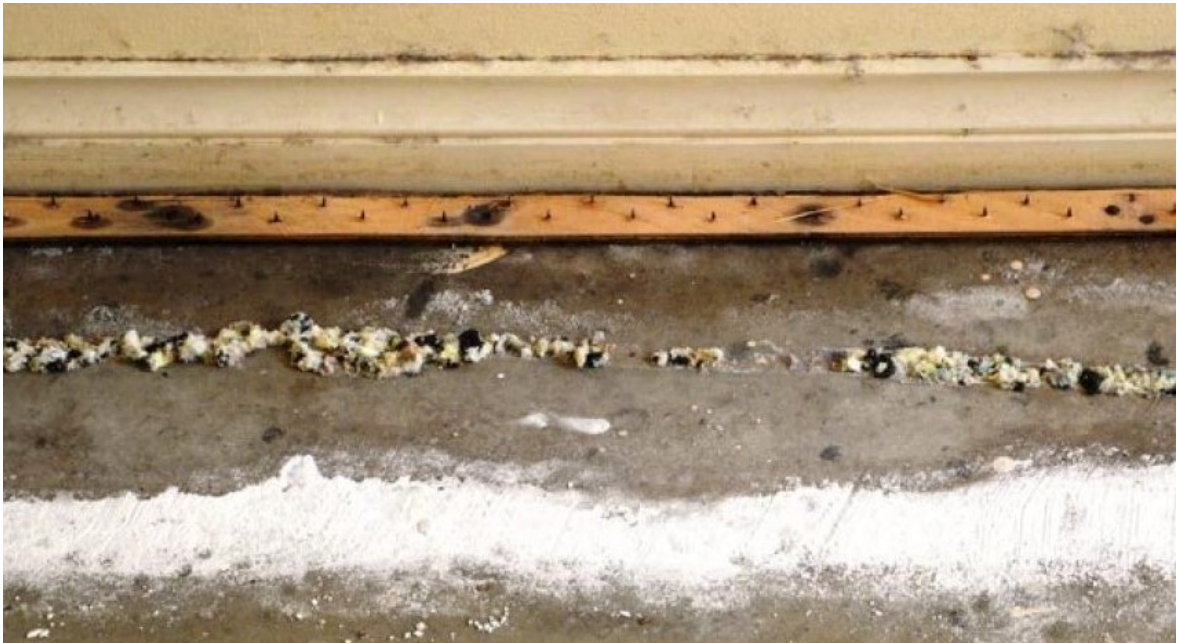
Picture A: Slab edge dampness
